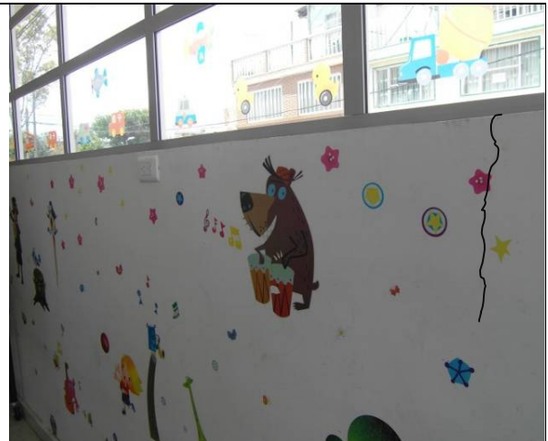
Fisuras en muros grado Jardín 1
