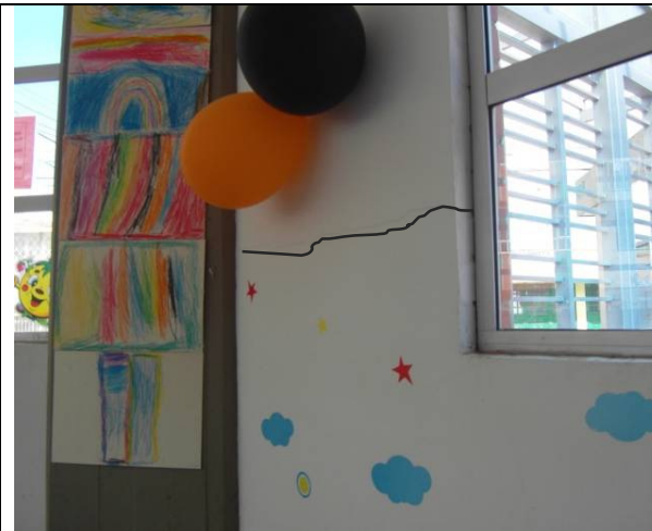
Fisuras en muros grado Jardín 1
